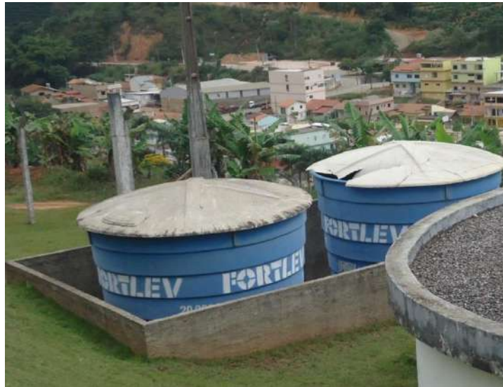
Figura 4 - Reservatórios de abastecimento público (capacidade - 20m 3 cada)
