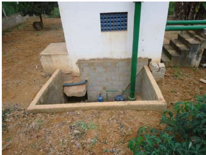
Figura 2 - Bomba de adução - capacidade 20cv
