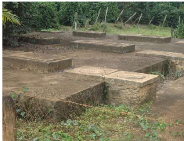
Figura 20 - Estação de Tratamento de Esgoto - Fossa-Filtro (São Jorge de Oliveira)
